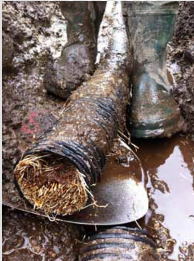
Rotinntrenging i drensrør. Foto Ståle Hustoft.
