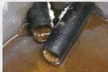
Grøftekum på areal med rustutfelling. Fleire sidegrøfter har innlaup her, og vidare transport i hovudgrøft. Tilgang til grøftespyling. Foto: Lars Sørdal
