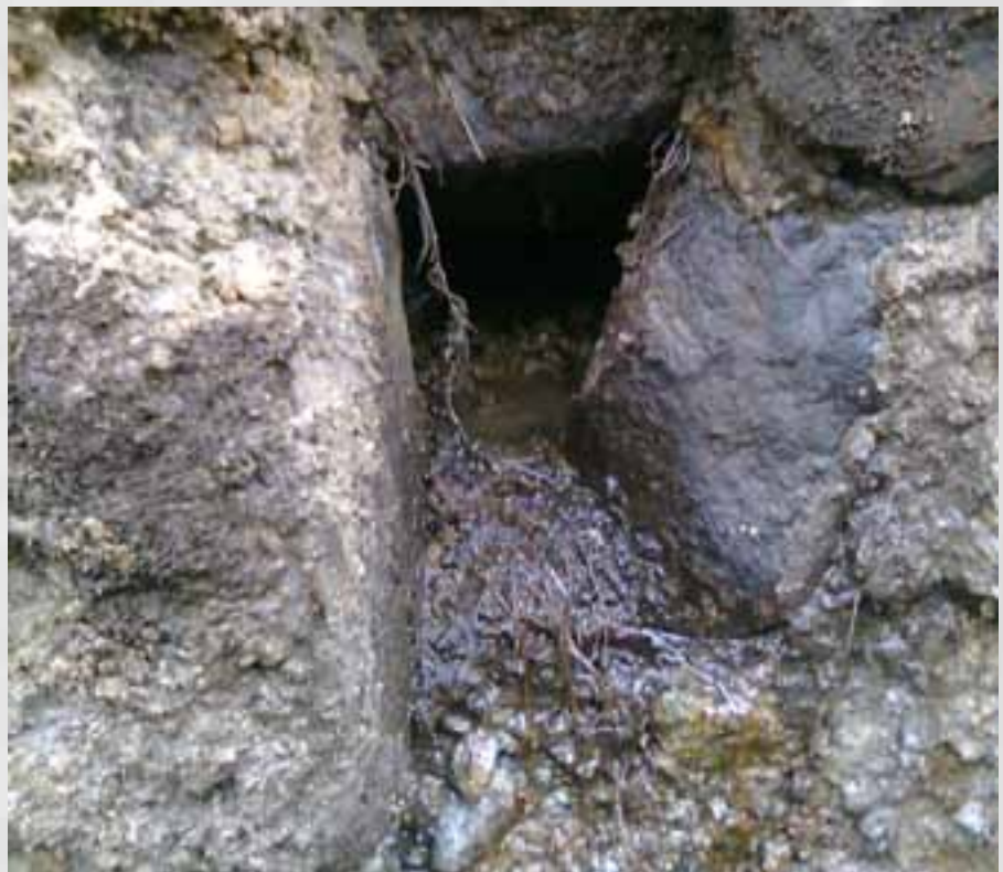
Bruk av stein som grøftemateriale var vanlig i tidligere tider. Mange steingrøfter er like fine i dag og gjør samme nytten som da de ble lagt av kyndige hender for 70 – 100 år siden. Dessverre fører kombinasjonen grunne grøfter og tunge maskiner ofte til at de gamle steingrøftene raser sammen og blir ødelagt. Foto: Geirmund Øglend
